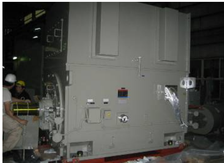
5850kW 4P 6.6kV 50Hz TEWAC Motor
